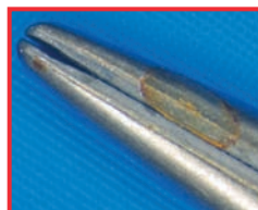
Atac acid pe suduri și inserții de metal cu deteriorare consecutivă sub formă de uzură vastă Cauza: supratratere
