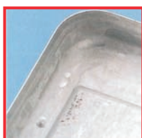
Atac de material. Cauza: Agent de curățare alcalin
