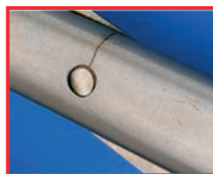
Fractură de balama hinge
